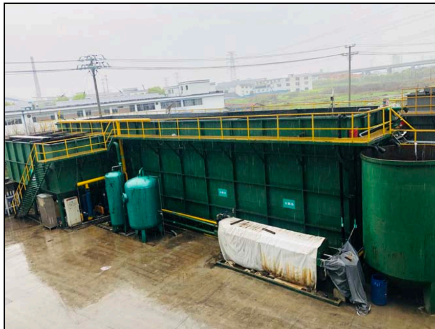
图 3-2 废水处理设施
