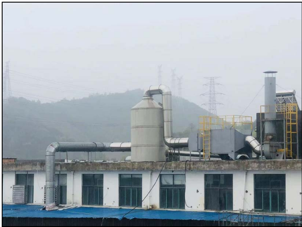
图 3-6 PVC 废气处理设施
